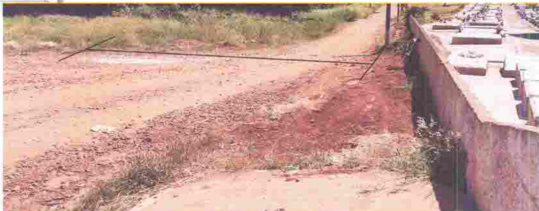
Imagem 04: Foto ilustrativa, para uma possível melhoria na via ao lado do cemitério municipal.
